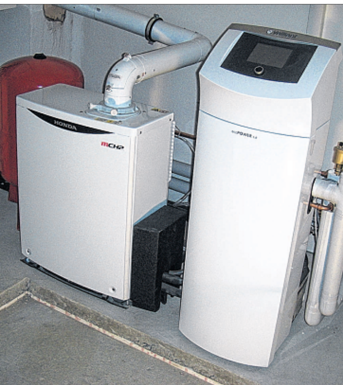
Ein wahres Kraftpaket, dieses Mikroblokheizkraftwerk.
